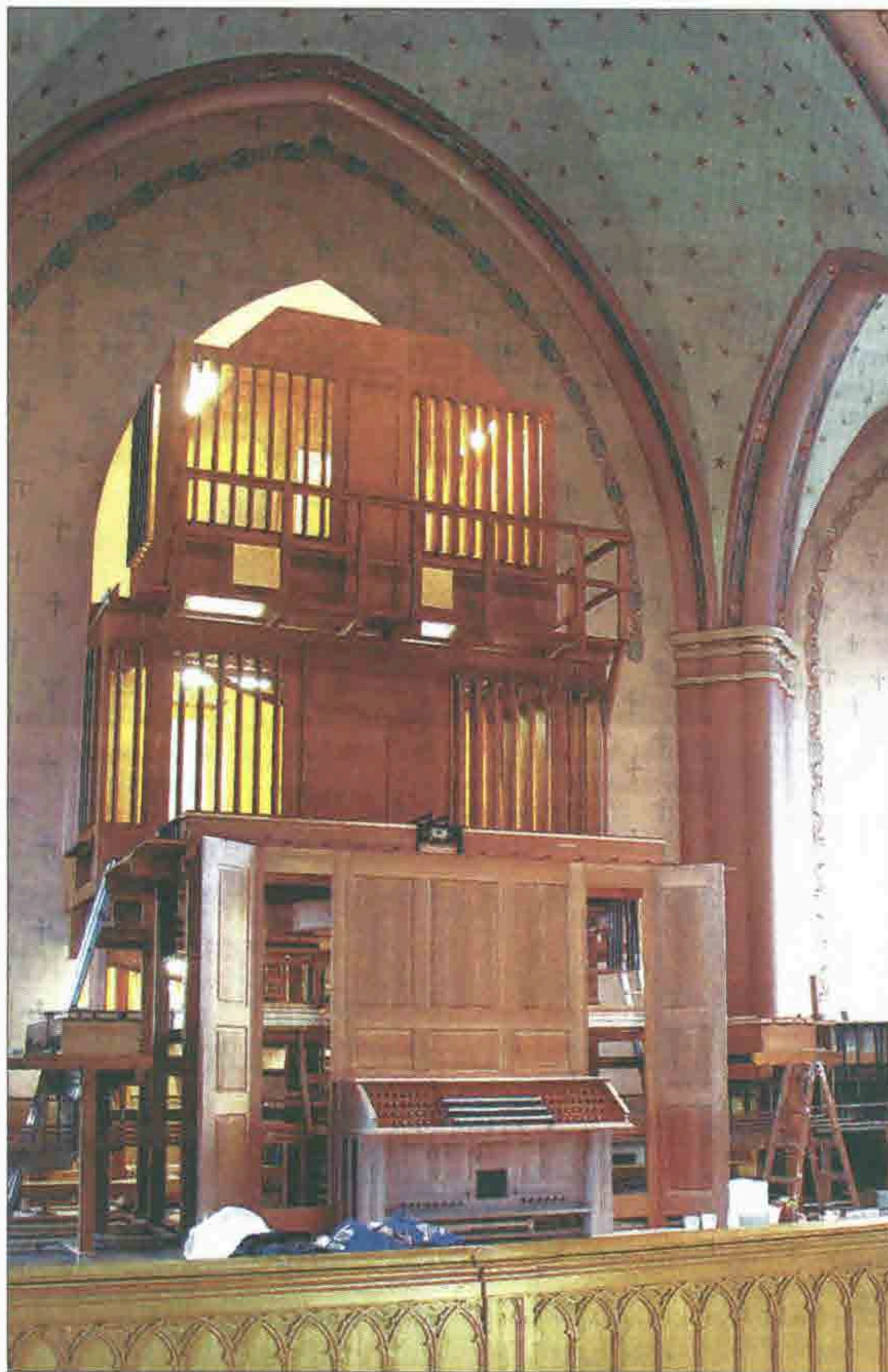
Soittopöytä ja kahdessa kerroksessa olevat paisutuspillistöt ovat jo paikoillaan.
