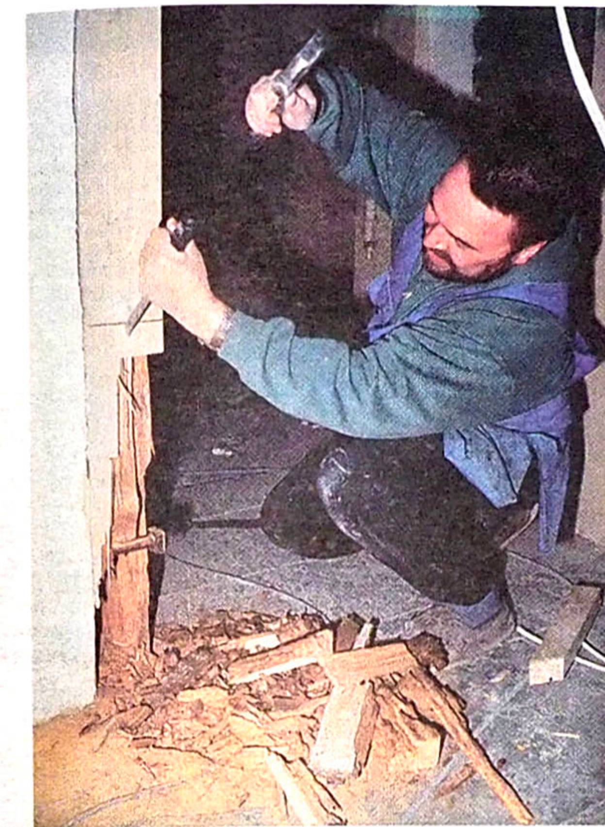
Matti Kuusman korjaa lehterin kannatinpylväitä, joista löytyi lahovaurioita.
